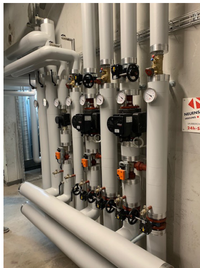
Heizungersatz Einbau Zähler für Fernablesung
